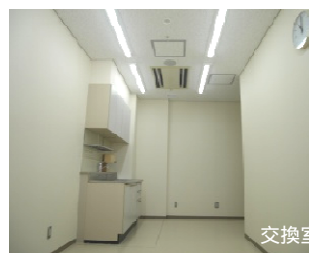
電話交換機室
