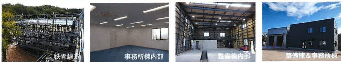
【社屋新築工事】～山県郡～ 事務所棟と整備棟の新築工事をさせていただきました。工事期間は約4ヶ月でした。
