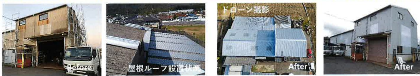
【工場スレート改修及び外壁明装工事】～安芸郡～ 屋根はリフレッシュルーフを取付け、外壁は水洗い後塗装しました。
